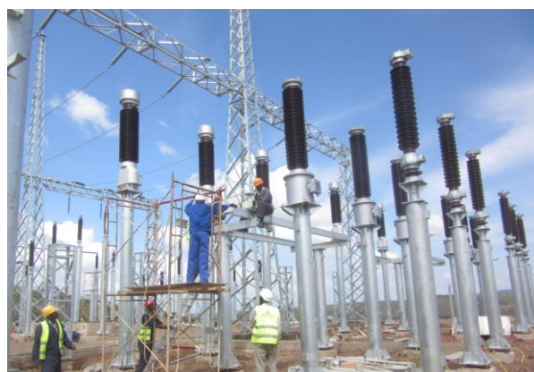
肯尼亚输变电路项目
