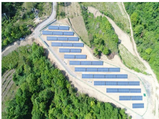
长阳县板凳坳村光伏电站
